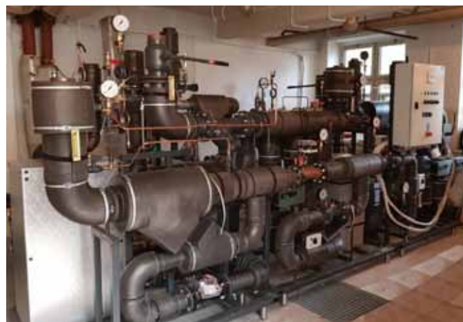
Do sieci PEC Sp. z o.o. przyłączył się w ostatnim czasie Szpital Specjalistyczny nr 2 w Bytomiu. Na terenie placówki zamontowano m.in. trójfunkcyjny węzeł ciepła
