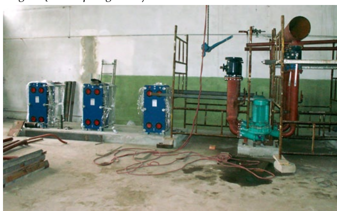
Z1B.24 – „Wymiana osiedlowej zewnętrznej instalacji odbiorczej zasilanej z GWC ul. Bema wraz z przebudową grupowego węzła ciepłego w Bytomiu” – modernizacja GWC ul. Bema.
