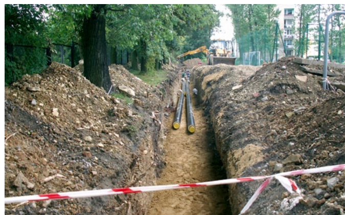
Z1A.25 „Wymiana osiedlowej zewnętrznej instalacji odbiorczej w rejonie ul. Armii Krajowej w Bytomiu zasilanych z GWC-15 ul. Adamka”.
