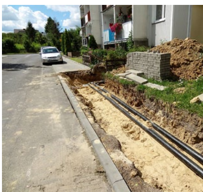
2012 r. Osiedlowa zewnętrzna instalacja odbiorcza po przebudowie ul. Sadowa w Radzionkowie.
