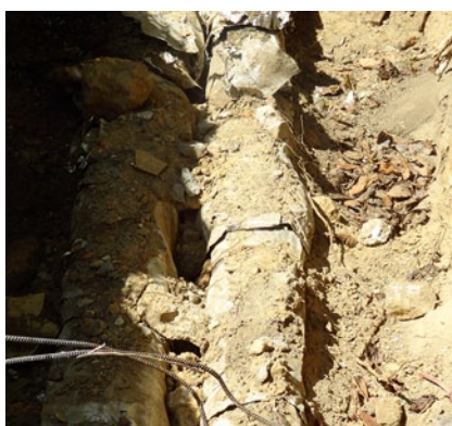
2012 r. Osiedlowa zewnętrzna instalacja odbiorcza przed przebudową ul. Sadowa w Radzionkowie.
