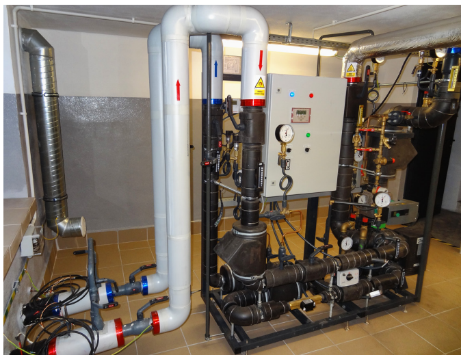
Nowy węzeł ciepły.
